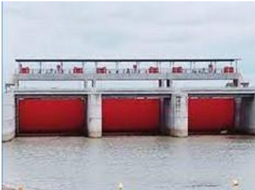
ภาพที่ 3-12 ประตูระบายน้ำ บานโค้ง
