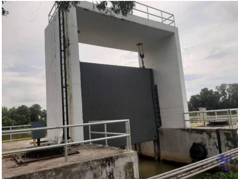
ภาพที่ 3-11 ประตูระบายน้ำ บานตรง
