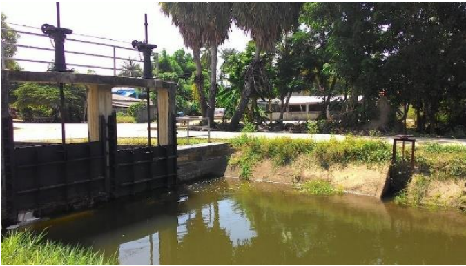
ภาพที่ 3-14 ทรบ. และประตู ปากคลองซอย
