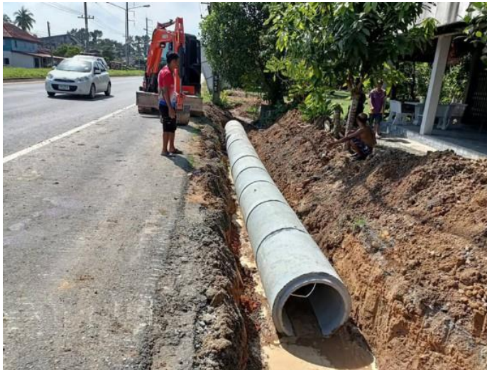
ภาพที่ 3-80 ท่อระบายน้ำ
