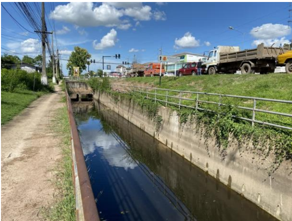
ภาพที่ 3-42 คลองระบายน้ำ
